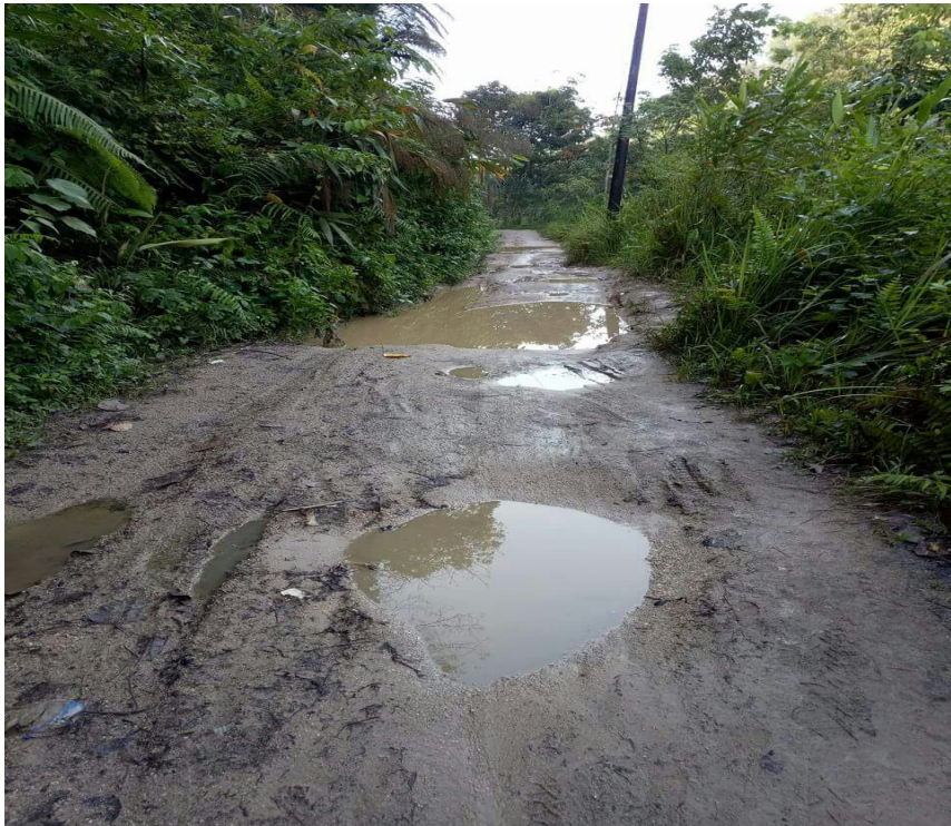
Gambar Jalan Rusak
